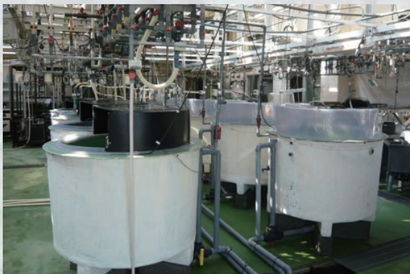
室内水槽(温度馴致水槽)
