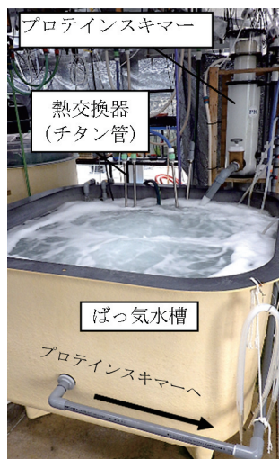
第5図 ばっ気水槽の外観と装備
